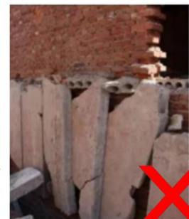
预制板质量不合格，断裂
