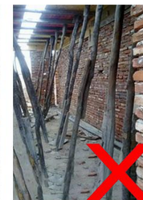
立杆接长未采用对接夹板接头
