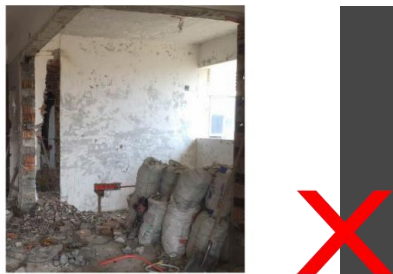
建筑垃圾，废渣集中堆在楼板上
