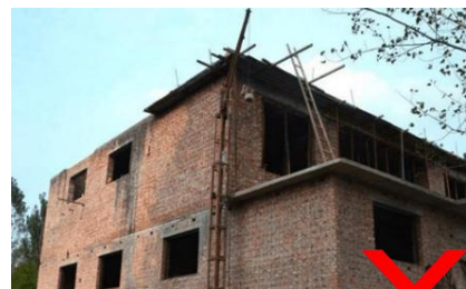
未设置圈梁，构造柱
