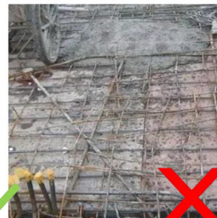
现浇板钢筋被踩踏
