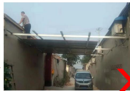
利用房屋墙体擅自搭设
