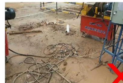
电缆线随意拉设
