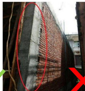
构造柱未留马牙槎
